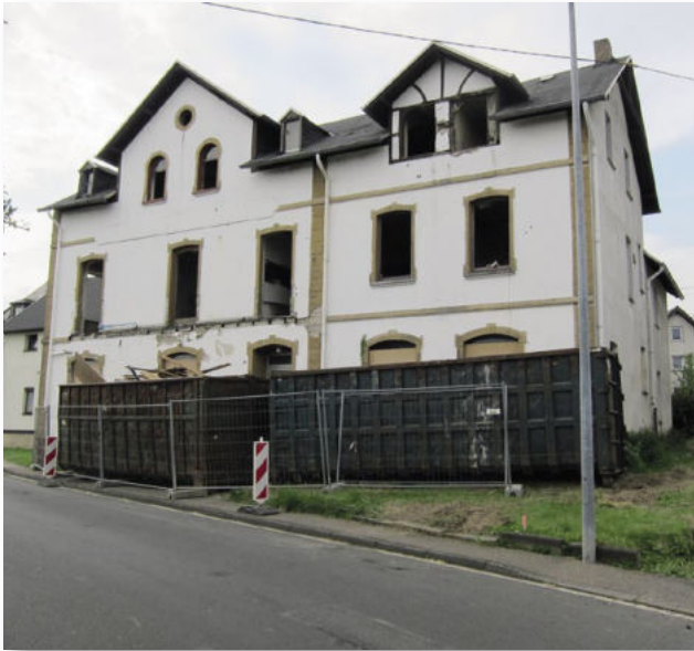
Ehem. Pension Haus Wilhelmsruh, beim Abriss 2012, von Dez. 1946 bis Okt. 1949 als Schule genutzt
